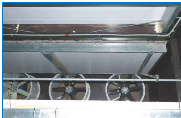
Выбросной клапан VENTOGLAS и мощные вентиляторы установленные в стене обратного действия (вид сверху).
